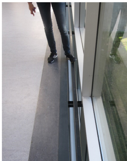
Mellemrum mellem facaden og gulvet
