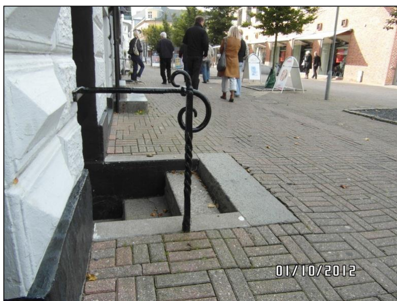
Fig. 3 – Utilstrækkeligt afskærmet kældernedgang på Nytorv
