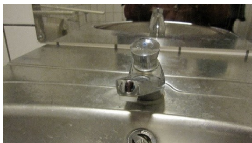
Armaturet på handi-captoiletet
