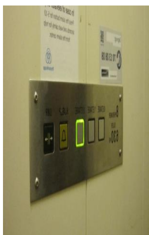
Det indvendige betjeningsanlæg i elevatoren i bygning 1331
