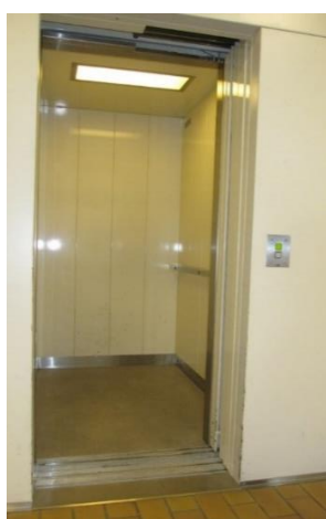
Elevatoren i bygning 1331
