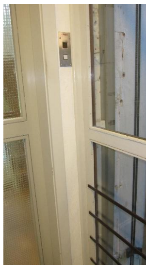
Det udvendige betjeningsanlæg i stueetagen (for elevatoren i bygning 1340)
