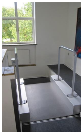
Trappeliften i bygning 1332
